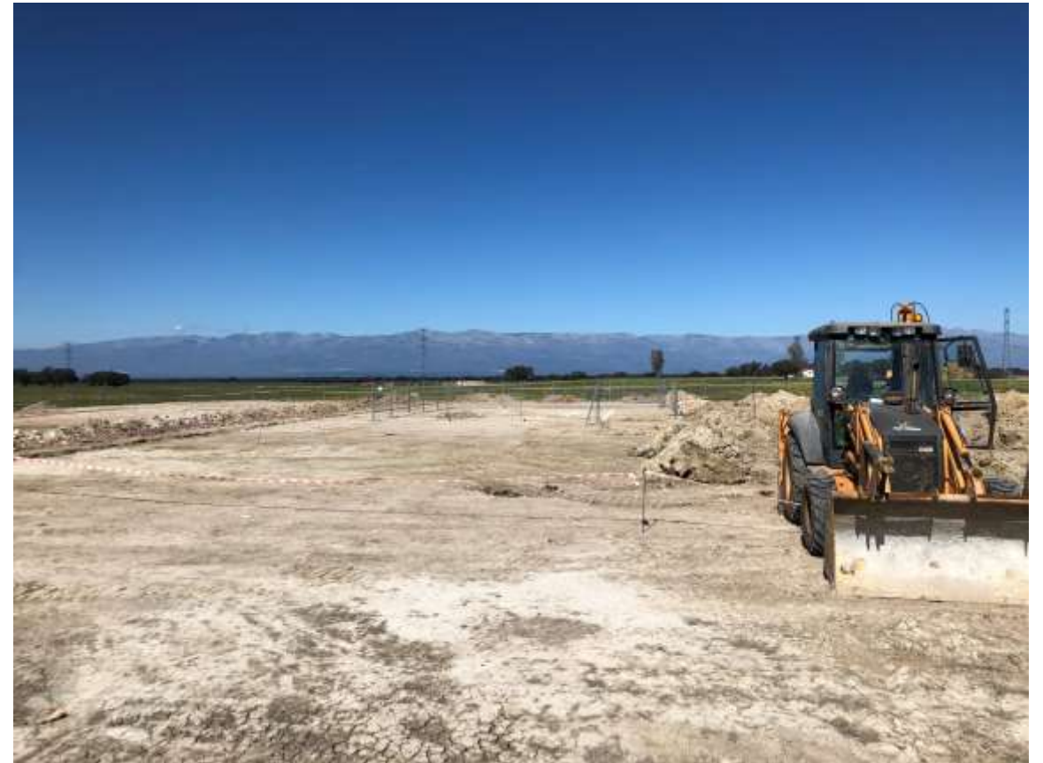
Bereich der Trafostation
